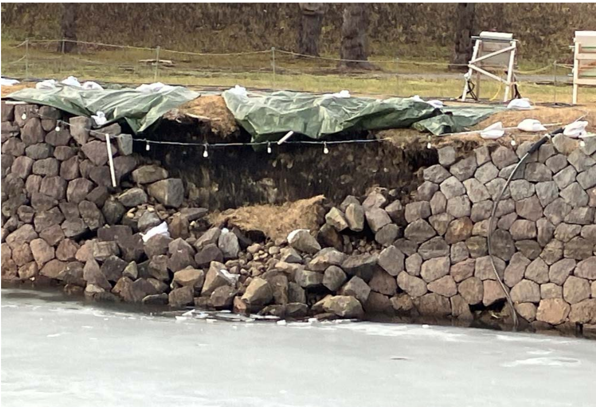
崩落箇所拡大写真
